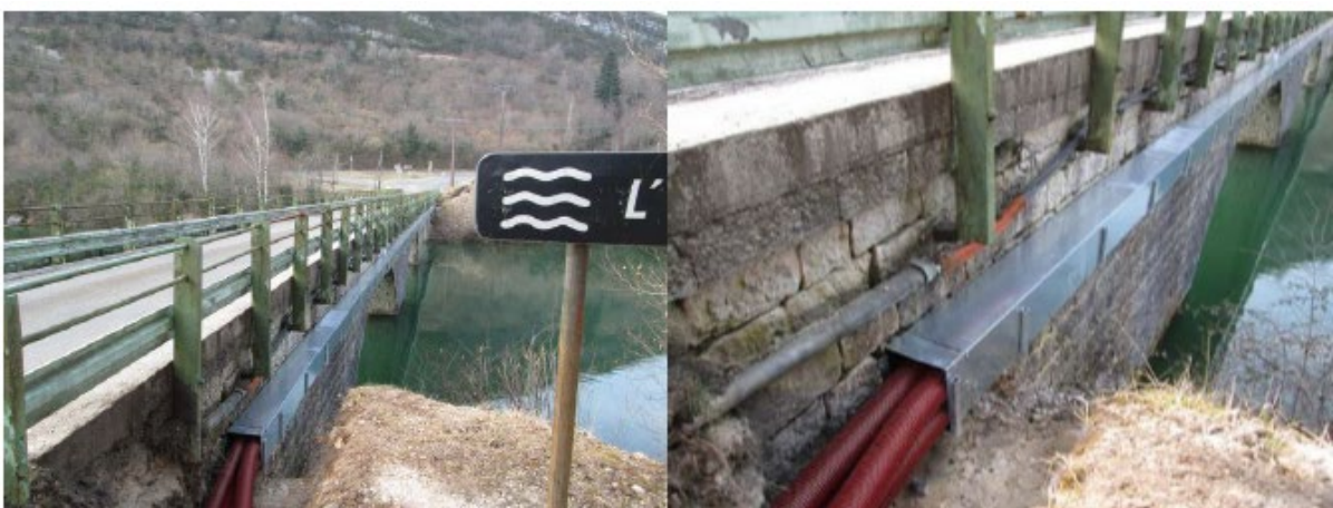
Exemple d'un passage de câbles HTA en encorbellement d'un ouvrage existant (Source : Tattu TP)
